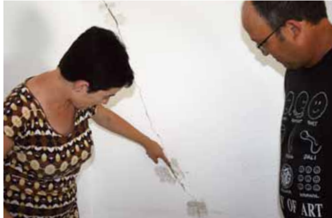
María José Campillo y Joaquín Andúgar, mostrando una de las grietas.
